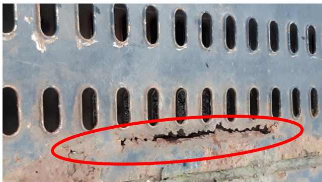
Рисунок 1а. Коррозия, проходящая через настил платформы
