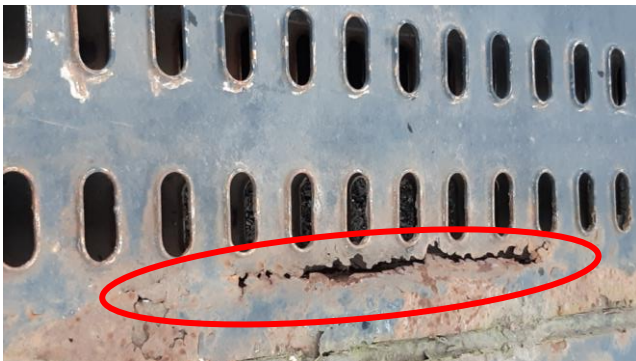
Abb. 1A: Oxidation durch das Fahrbahnelement
